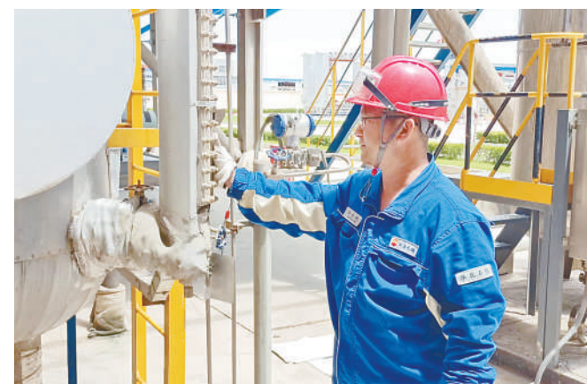
任永刚在现场检查连续重整装置运行情况。柴志玲 摄
